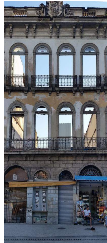
Figura 26: Foto de trecho do conjunto urbano em que resta apenas a fachada. Nota-se ao lado direito a existência de pequeno comércio, o proprietário apropriou-se de parcela da ruína. Fonte: arquivo pessoal.
