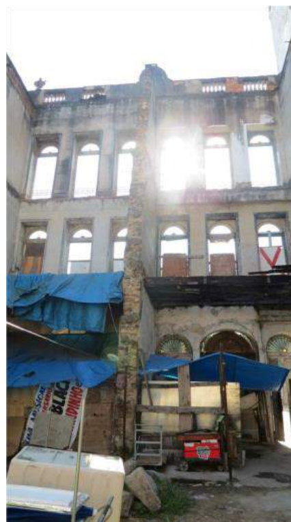
Figura 91 e 92: Imagens internas da ruína. Foto dos fundos do lote e do lado interno da fachada principal. Fonte: Imagens disponibilizadas pela arquiteta Luiza Sertã.
