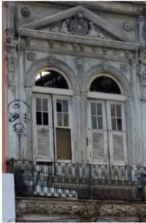
Figura 31: Detalhe da edificação em estado de arruinamento na Rua da Constituição. Fonte: arquivo pessoal.
